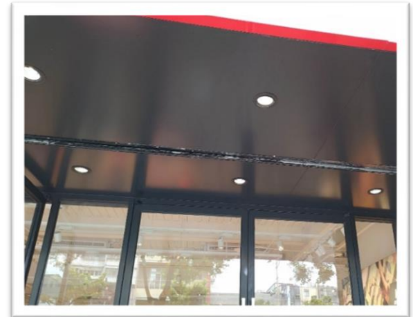
騎樓燈具未關閉(日光充足)
