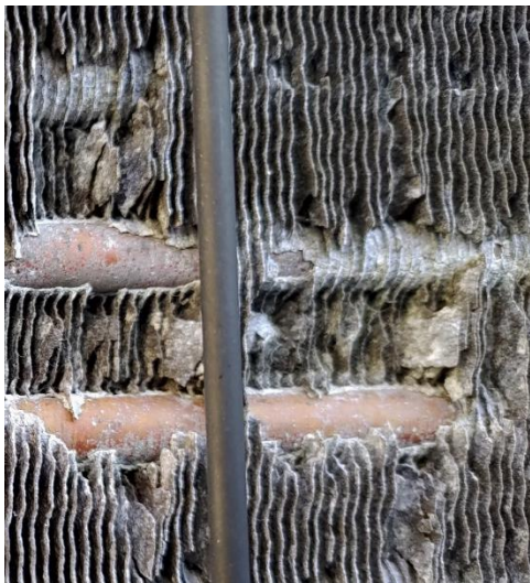
空調散熱鰭片腐蝕
