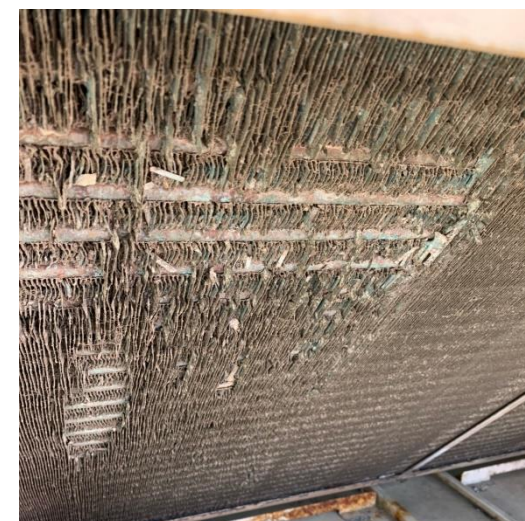
室外機鰓片剝落破損
